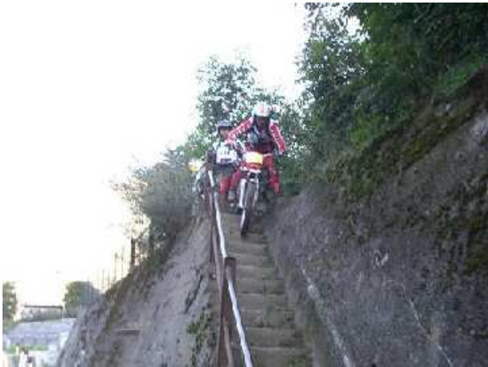
eine nette Treppe mit Kratzspuren an der Wand...
